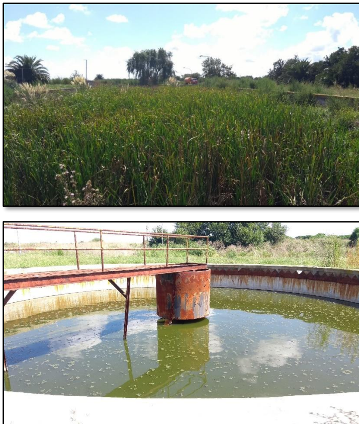
Figura 4. Componentes de tratamiento en desuso. Sedimentador con estructuras oxidadas y eutrofización (se registra olor fétido intenso).
