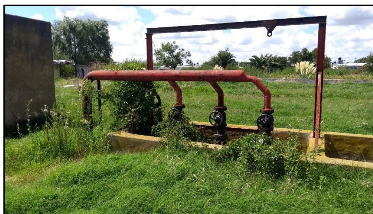
Figura 5. Abandono de sector de cámara de bombeo en desuso, con crecimiento de vegetación.
